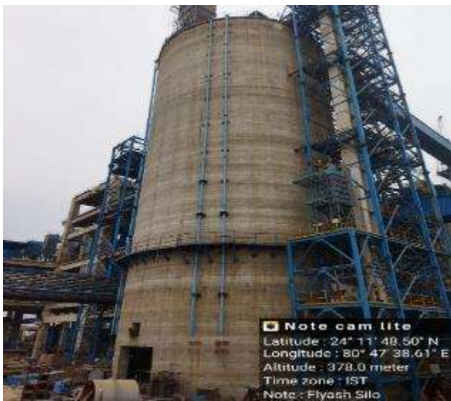
Fly Ash Silo
